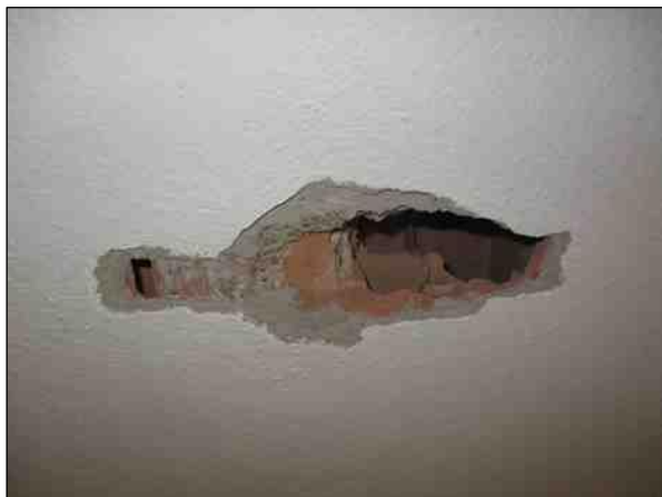
Foto n°7 - Individuazione della Tipologia Solaio 1 attraverso la micro demolizione effettuata al piano terra.
