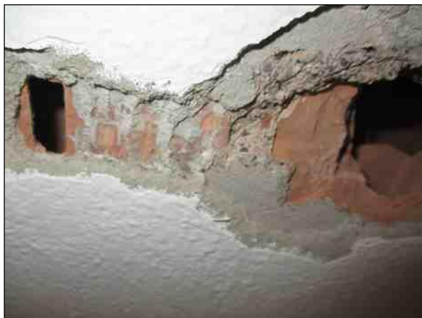
Foto n°9 - Particolare del travetto gettato in opera.
