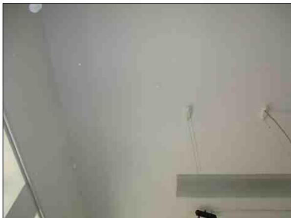
Foto n°12 - Porzione del plafone presente nell'Aula Multimediale al piano terra connotata da una condizione pericolosa.
