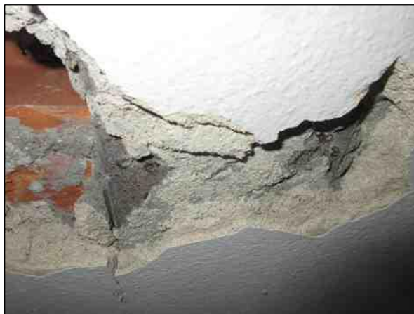
Foto n°4 - Dettaglio della putrella in acciaio.
