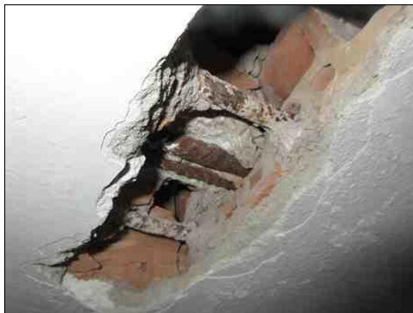
Foto n°2 - Particolare del travetto gettato in opera in cui sono stati rilevati 2Ø14 e 2Ø10.
