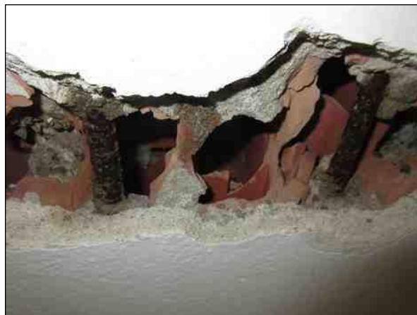
Foto n°4 - Dettaglio dell'analisi della profondità di carbonatazione eseguita sul travetto gettato in opera.
